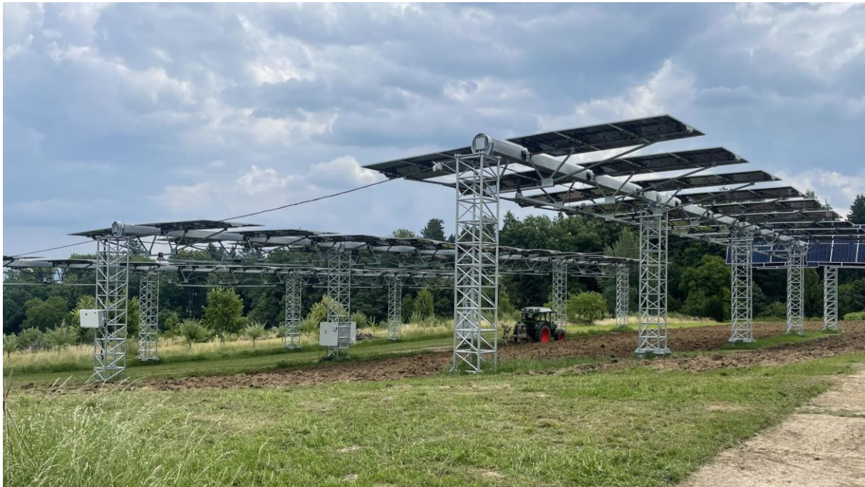
Abb. 1: Agri-PV-Anlage am Campus Grüental der ZHAW, Wädenswil. © ZHAW
